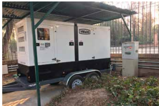
Generador y tablero de transferencia. Respaldo de energía
